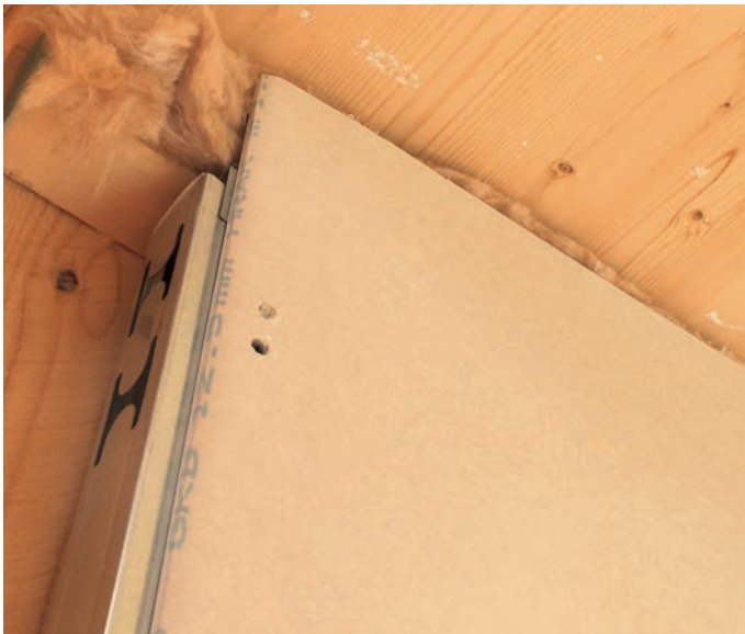
Abb. 2: Falsche Platten durch Trockenbauer vor Ort montiert
