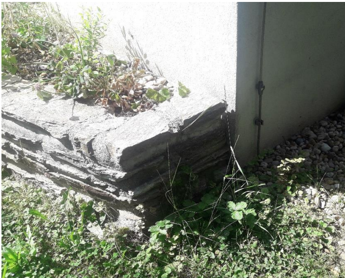
Abbildung 8: nachträglich errichtetes Blumenbeet an der Holzwand. Bild: Autor
